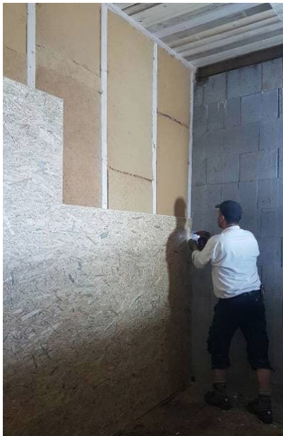
Bild: Aufbau der Kammern für Klimamessungen (Foto: Kay Arnswald)
